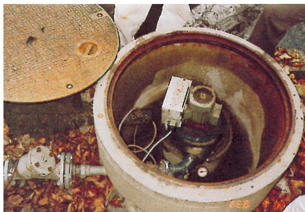
Figura 7.1 - Microturbina di 250 W installata da un privato nei pressi di Losanna e che viene utilizzata per la ricarica di batterie.
