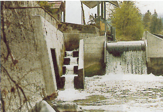
Figura 3.5 - Scala per pesci a bacini successivi a Bärâu nei pressi di Langnau (BE).
