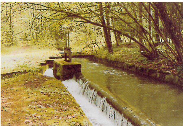
Figura 2.6 - Dissabbiatore combinato con sfioratore e valvola di svuotamento, a monte del canale di derivazione di una piccola centrale a Aigle (VD).
