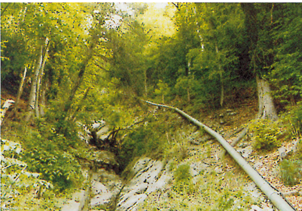
Figura 4.7 - Condotta forzata in acciaio installata in superficie su un terreno piuttosto sconnesso.
