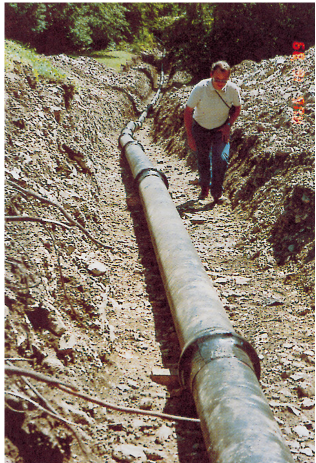
Figura 2.8 - Condotta forzata in ghisa con raccordi autobloccanti, che alimenta la microcentrale del comune di Brienzwiler (BE).
