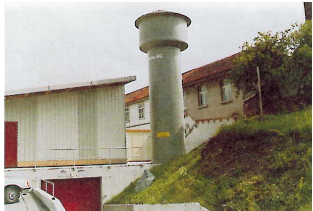
Figura 4.4 - Castello d'acqua in materiale sintetico (pozo di compensazione).
