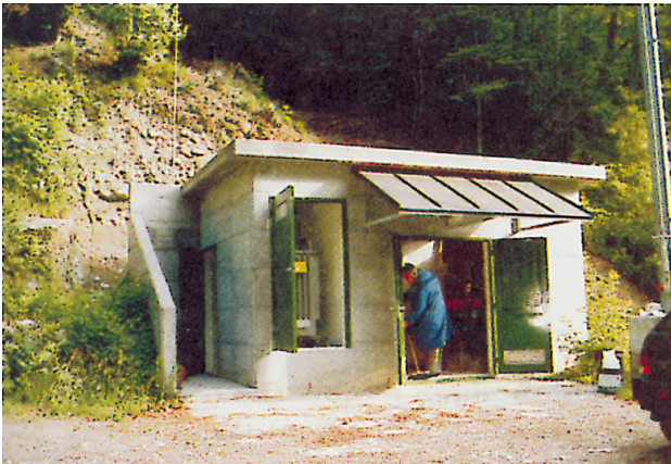
Figura 4.8 a) - Centrale con trasformatore.
