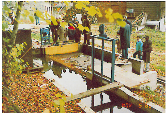
Figura 2.7 - Sgrigliatore autopulente con presa di tipo tirolese della piccola centrale di Moulin de Bavois (VD).
